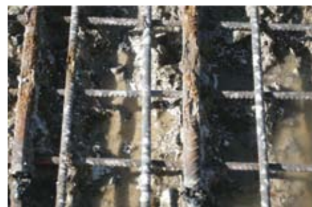
État d'origine des armatures corrodées.
